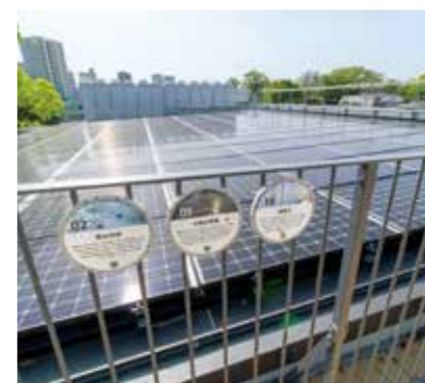
屋上の太陽光発電パネル
