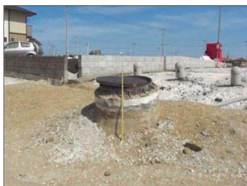
液状化で浮き上がったマンホール
