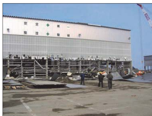
津波被害を受けた北日本造船の建物
