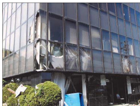
津波で傷んだ2階部分の外壁
