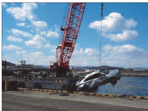
漁港に沈んだ自動車を引き上げる
