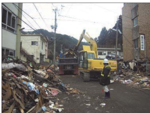
啓開が進む釜石市役所前の道
